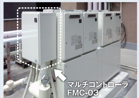
「MT-4G」はマルチコントローラの内部設置
